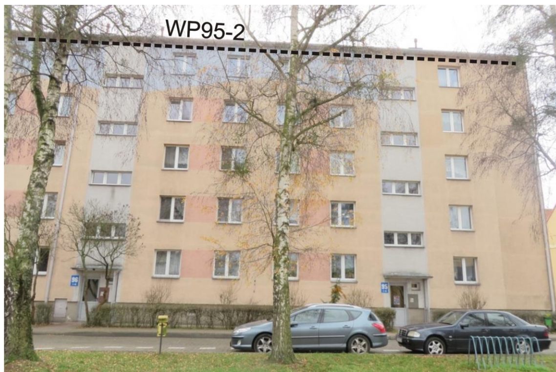
Ryc. 47. Ściany północno-wschodnia budynku na os. Wojska Polskiego 95-97 z zaznaczeniem pozycji opisanych w tekście
