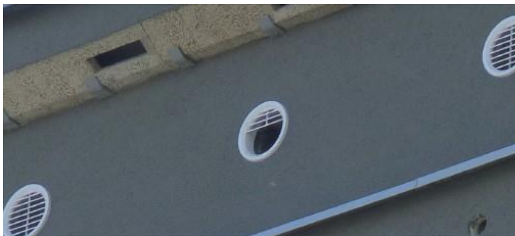
Ryc. 56. Kratka wentylacji stropodachu z wylamanymi lamelkami celem umożliwienia ptakom wejścia do stropodachu (za: Zyskowski i Zielińska 2015).
