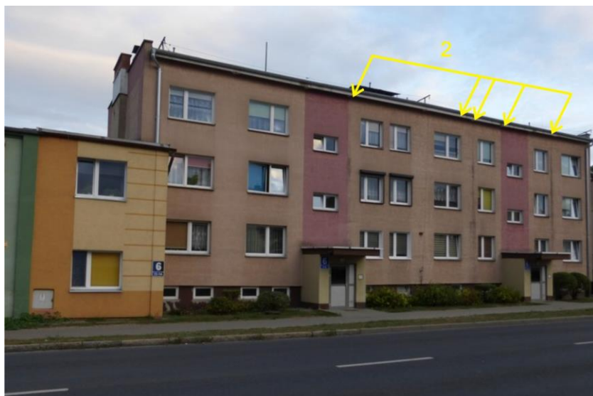
Ryc. 6. Ul. 27 Stycznia 6 – elewacja zachodnia z zaznaczeniem siedlisk zwierząt
