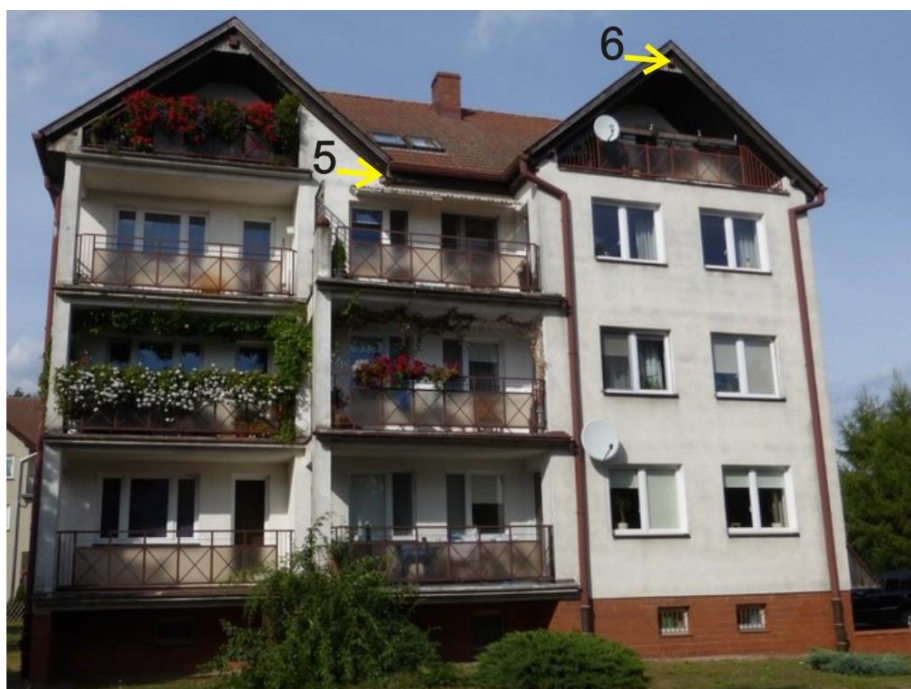
Ryc. 46. Ul. Strażacka 3 – elewacja południowa z zaznaczeniem siedlisk zwierząt
