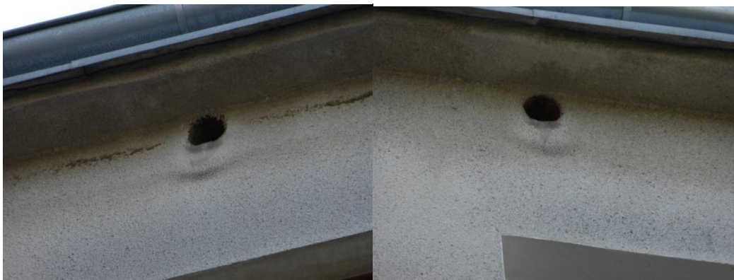
Poz. OZ10-2. Gniazdo oknówki, w części zniszczone – 1 gniazdo i siedlisko oknówki.
