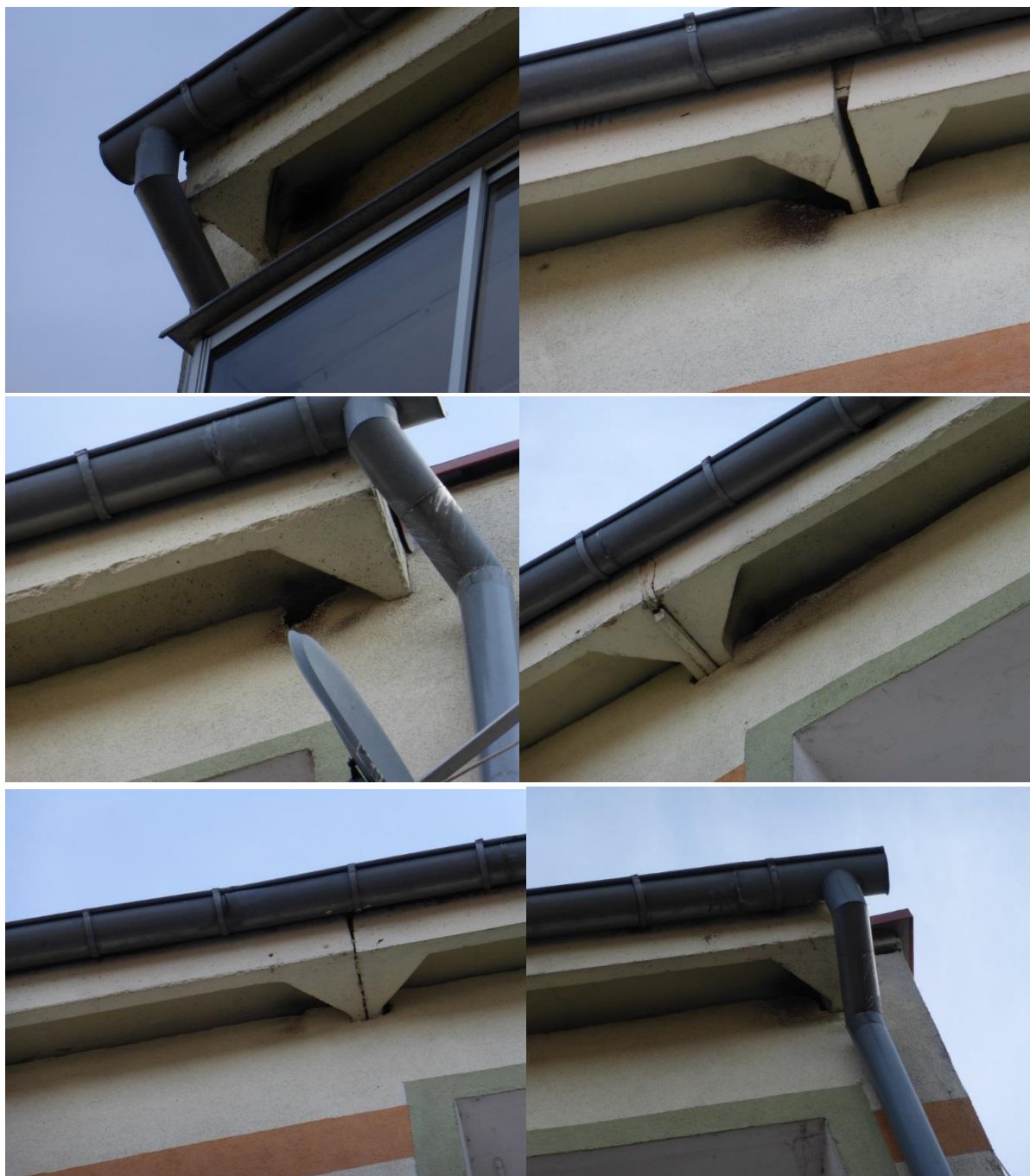
Poz. 25Lecia9-2. Na elewacji zachodniej pomiędzy żelbetowymi płytami dachowymi a ścianami zewnętrznymi budynku istnieje szczelina o zmiennej szerokości, pod którą jest liniowe wybrudzenie od ciała ptaka – 9 siedlisk jerzyka i 5 potencjalnych siedlisk nietoperzy.
