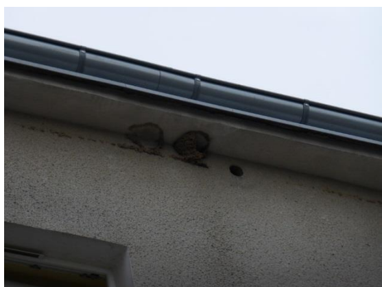
Poz. OZ3-5. 12 otworów do stropodachu, zabrudzenia od ciał ptaków są, choć słabo widoczne, pod niektórymi kał. Wg mieszkańców otwory są zasiedlone przez jerzyki. – 12 siedlisk jerzyka.
