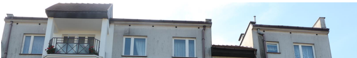
Ryc. 3. Otwarte otwory do stropodachu na budynku Os. Młodych 4.
